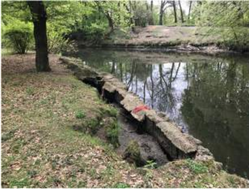
Erosione delle sponde e scalzamento muro spondale
