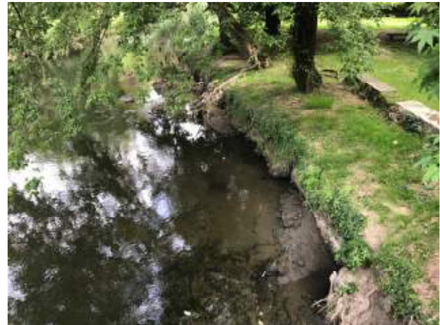
Erosione delle sponde
